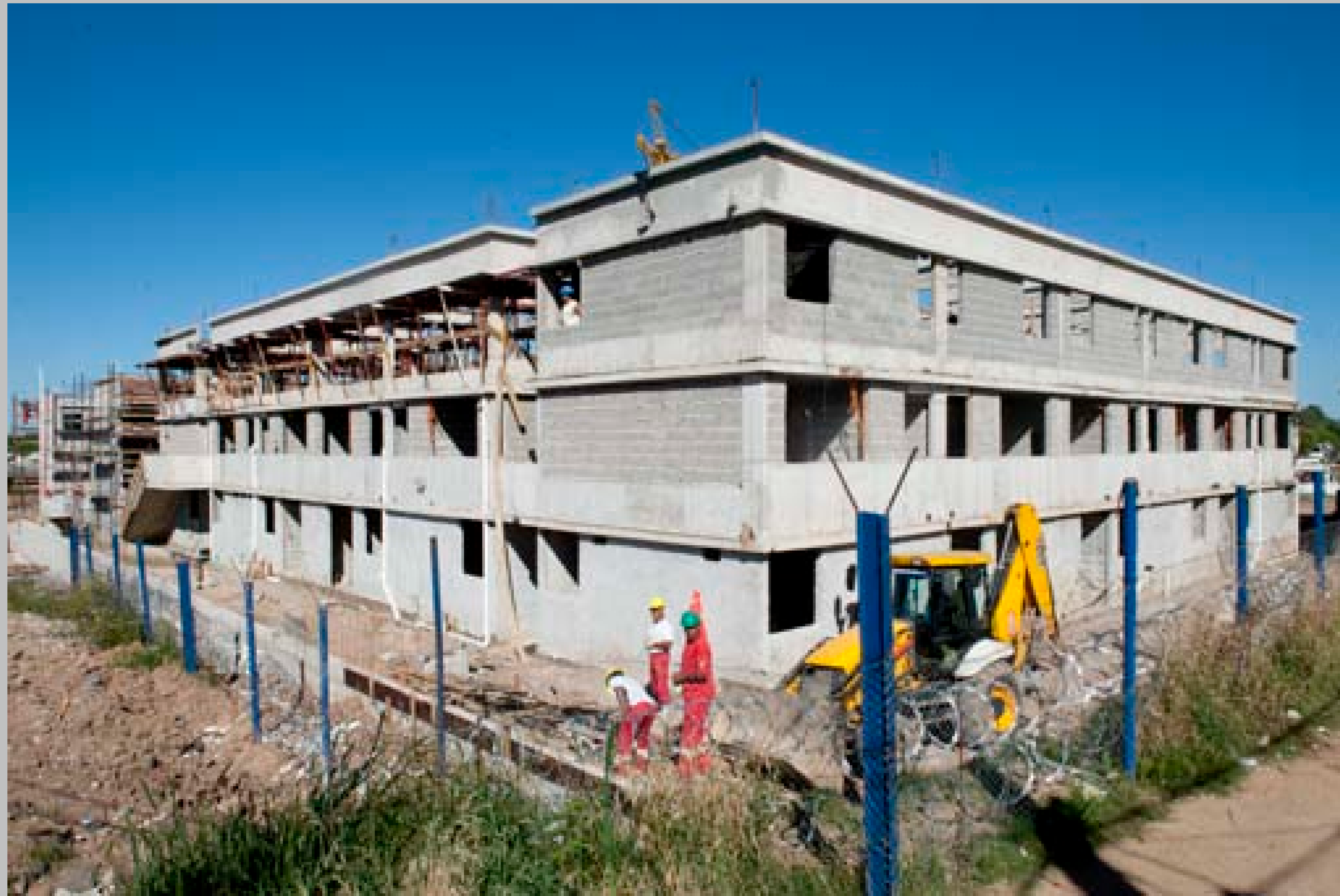
Construcción de viviendas para los habitantes del asentamiento Siete Manzanas. Esquina de Camino Maldonado y la avenida Del Zodíaco. 18 de diciembre de 2014. (Fotos: 52013FMCMA.CDF.IMO.UY - Autor: Carlos Contrera/CdF).
